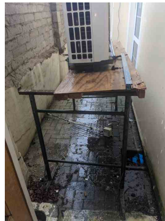
MH.6 U.T.R AIR CON UNIT PRECARIOUS ON TOP
